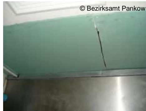
Bild 1: nicht fertig gestellte Deckenverkleidung
