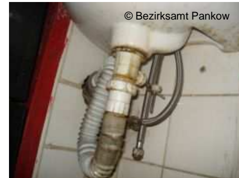
Bild 4: undichter Abwasserablauf am Waschbecken
