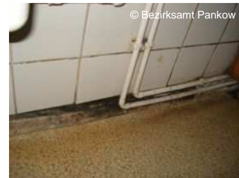
Bild 6: Wand und Fußboden stark verschmutzt
