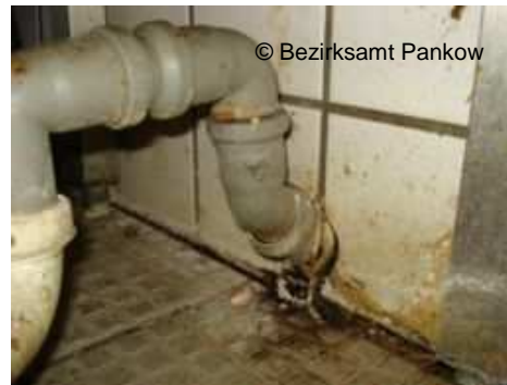
Bild 3:Abfluss undicht, Umgebung verschmutzt
