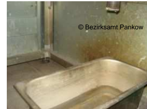
Bild4: freies Ableiten von Abtauwasser
