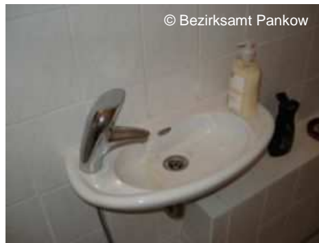
Bild 3: Handwaschbecken (WC) undicht fehlende Papierhandtücher
