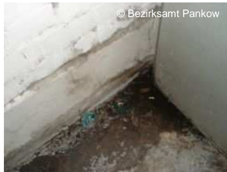
Bild 5: Fußboden unsauber, feucht, Versiegelung abgenutzt
