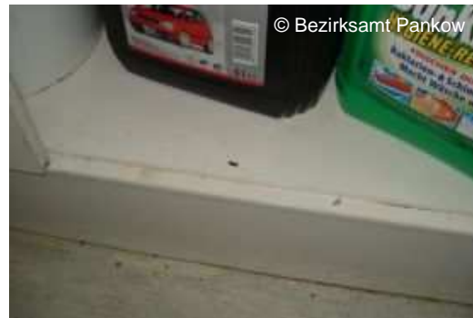
Bild 1: Unterschrank mit Mäusekot
