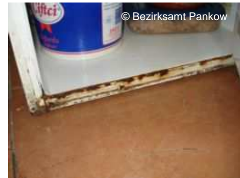
Bild 4: Schmutzablagerungen am Kühlschrank
